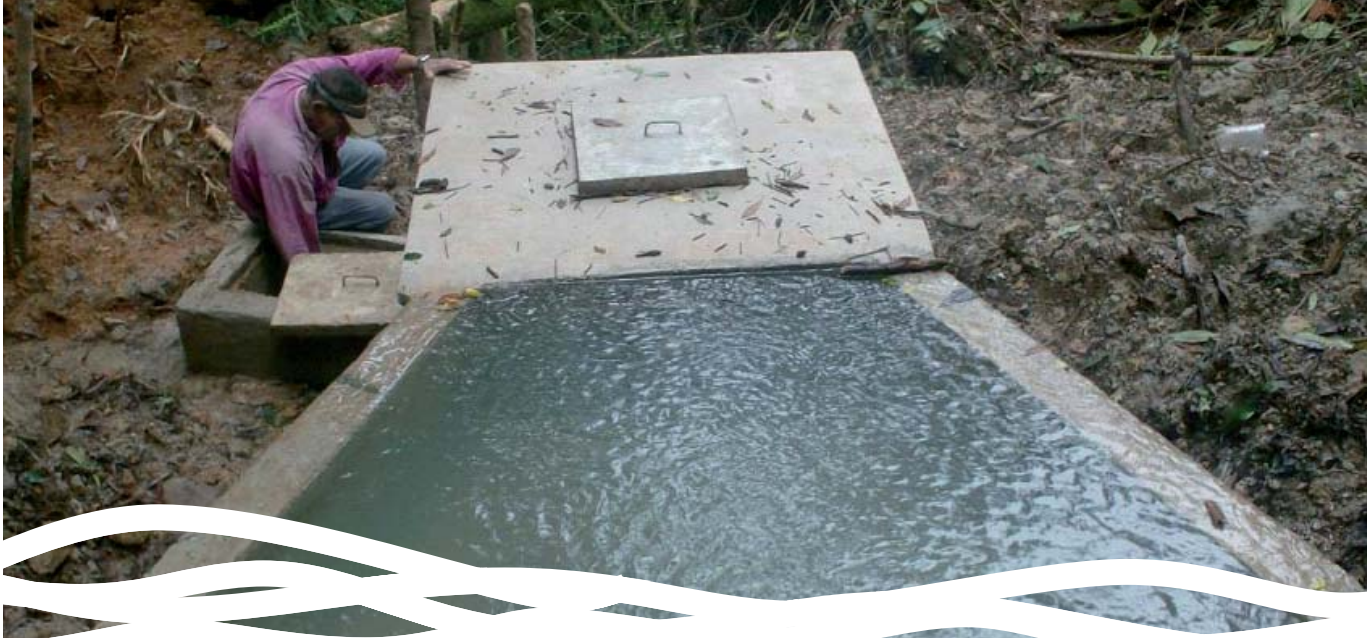
Una de las obras de toma del Sistema de Agua y Saneamiento de San Marcos
