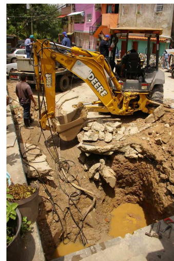
Aspecto de las reparaciones del Alimentador Norte, iniciadas en agosto de 2010 (Foto: Prensa Alcaldía Sucre)
