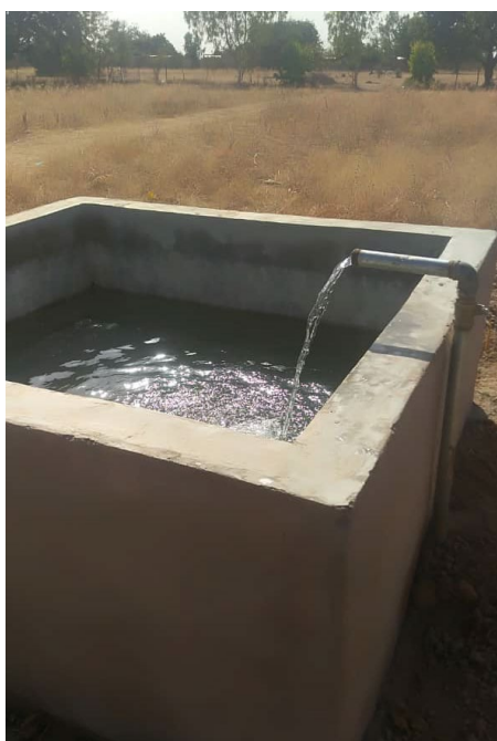
Photo 2.10.3.4.4. : Bassin de stockage
