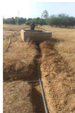
Photo 2.10.3.4.3. : Vue des conduites
