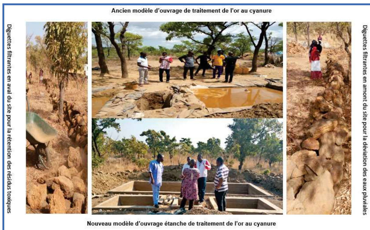
Photo 2.9.2.2.1. : Ouvrage étanche de traitement écologique de l'or au cyanure
